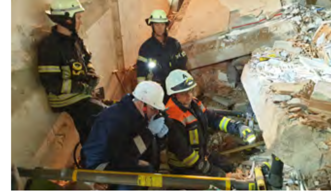
Ein äußerst belastender Einsatz für alle Rettungskräfte.
